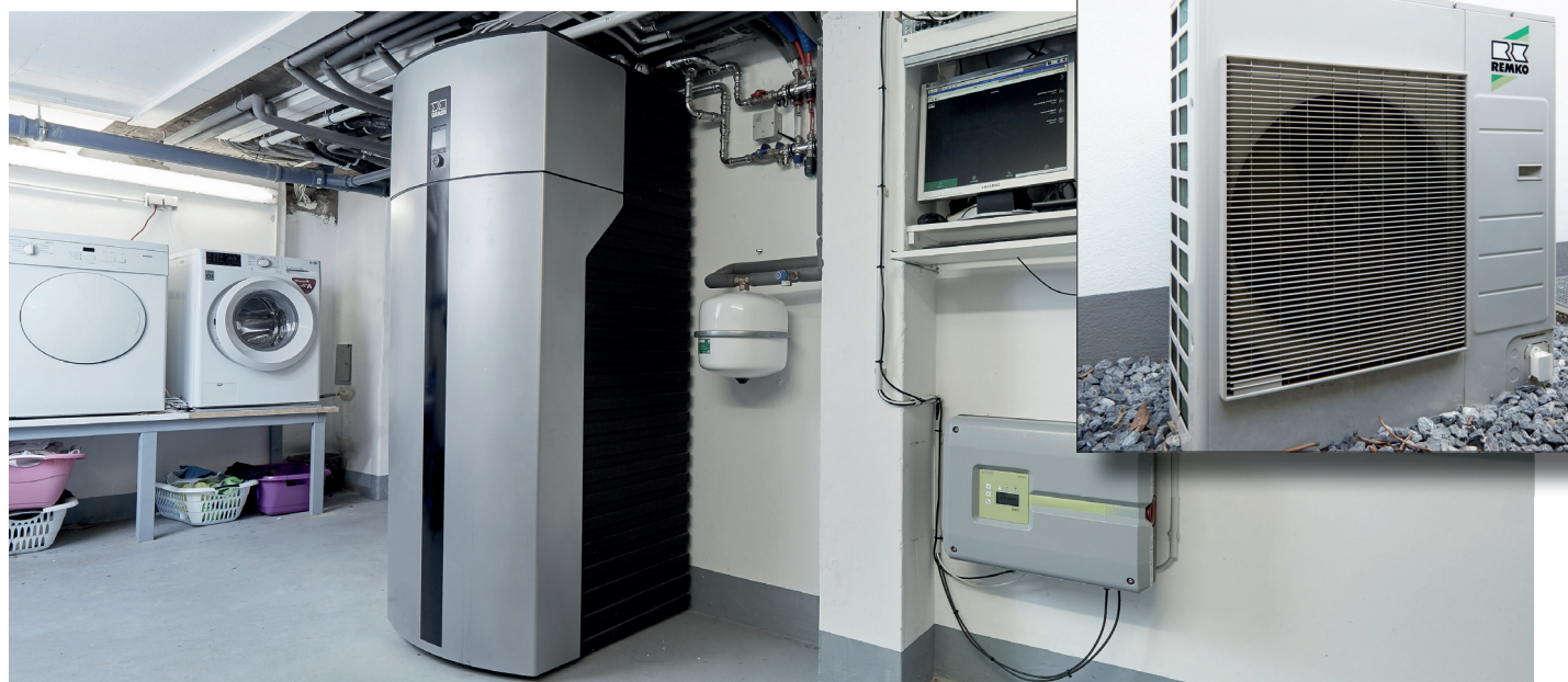
Eine Wärmepumpe WKF compact mit integriertem Speicher und 12 kW Leistung bildet den Mittelpunkt der neuen Anlage. Kleines Bild: Das Außenmodul des Splitgerätes wurde neben dem Haus platziert, die Wege zur Anbindung waren kurz. Die Luft strömt seitlich in das Außenmodul und gibt ihre Energie ab.
