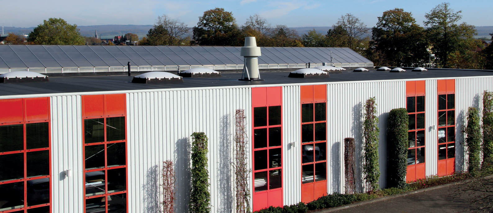
Firmengebäude in Bad Lippspringe mit wärmerückgewinnendem Dachventilator
