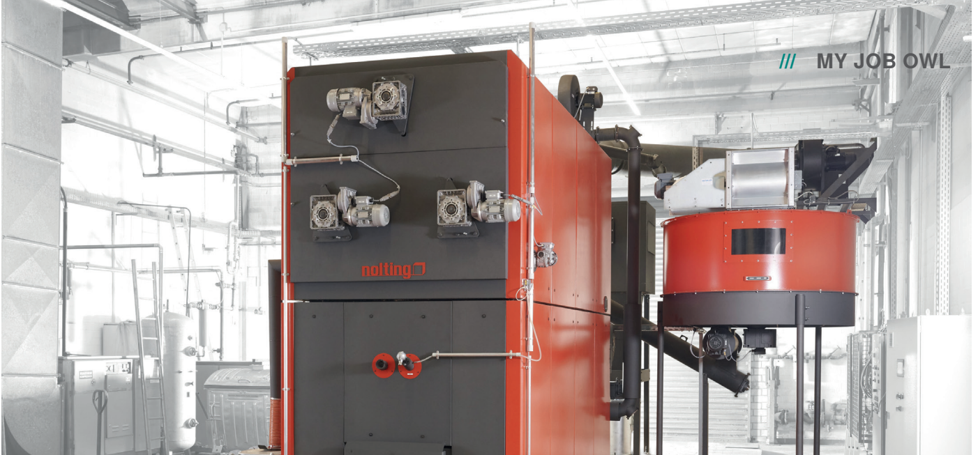
Ein Anlagenbeispiel mit 1.500 kW der Firma Nolting Holzfeuerungstechnik aus Detmold.
