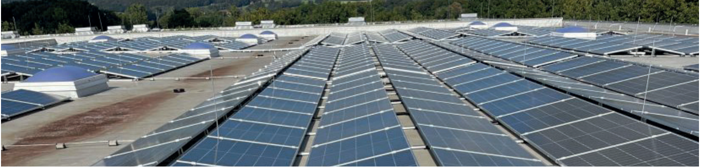
Die PV-Anlage auf dem eigenen Dach versorgt das Distributionszentrum der AGRAVIS in Nottuln mit Energie.
