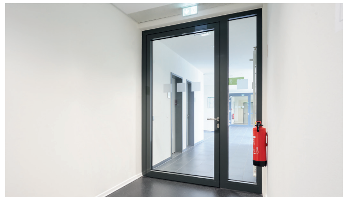
Der Einsatz von Brandschutztüren in Fluren ist gängige Praxis. Dabei ist diese Einbausituation nicht in der Prüfnorm DIN 4102-5 / EN 1634-1 vorgesehen.
