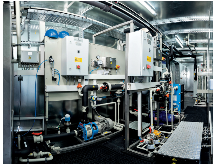
Verdunstungsanlage in neuem Einsatzgebiet
