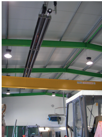
EIN DOPPELROHRSTRAHLER TEMPERIERT DIESE TRAKTORENHALLE. (FOTO: VACURANT)
